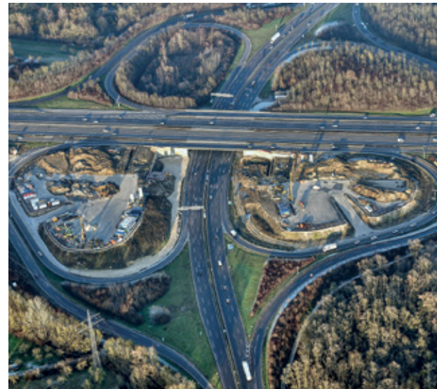
Blick auf die Baustelle an der BAB 8, Anschlussstelle Wendlingen. Bildnachweis: Arnim Kilgus / Deutsche Bahn.
