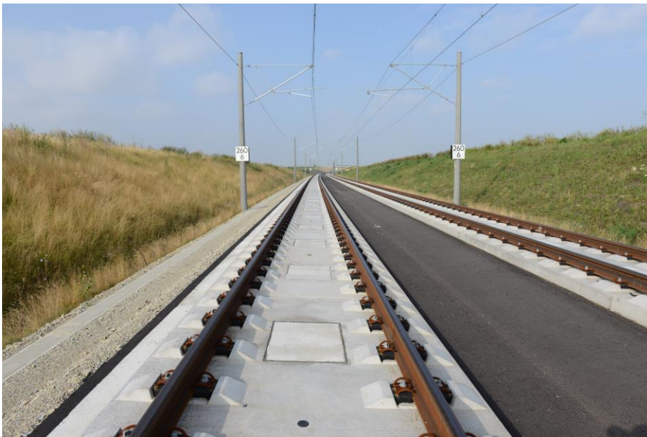
Bildunterschrift: Die Slab Track Austria Technologie wird in Europa und Asien erfolgreich bei Hochgeschwindigkeits-, U-Bahn- und Sanierungsprojekten eingesetzt. (Copyright: © PORR)
