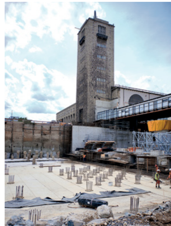
Die Pfahlköpfe der Frankipfähle NG® sind freigelegt und teilweise bereits gekappt. ©Stump-Franki
