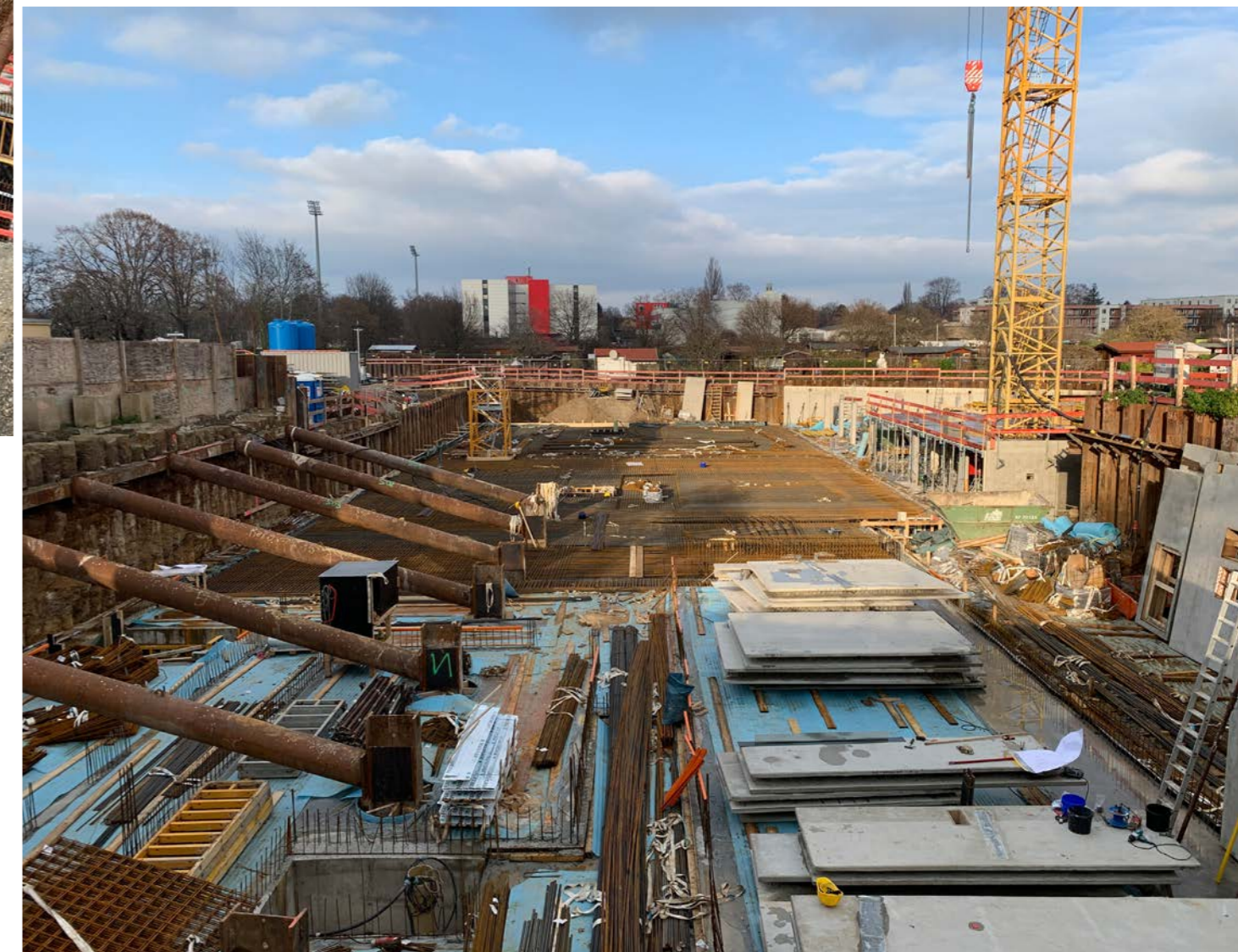
Das Spezialtiefbau-Team konnte seine ganze Expertise bei der wirtschaftlichen und termingerechten Errichtung von Baugruben einbringen.
