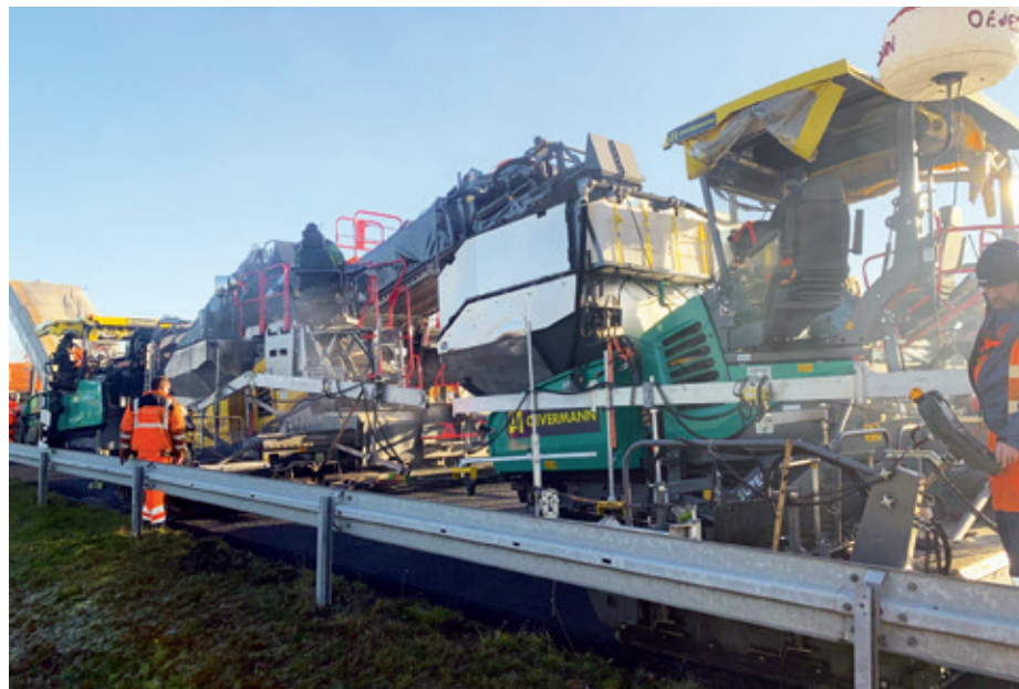
Bei InLine Pave arbeiten alle Maschinen direkt hintereinander „in line“, also in einer Linie.
